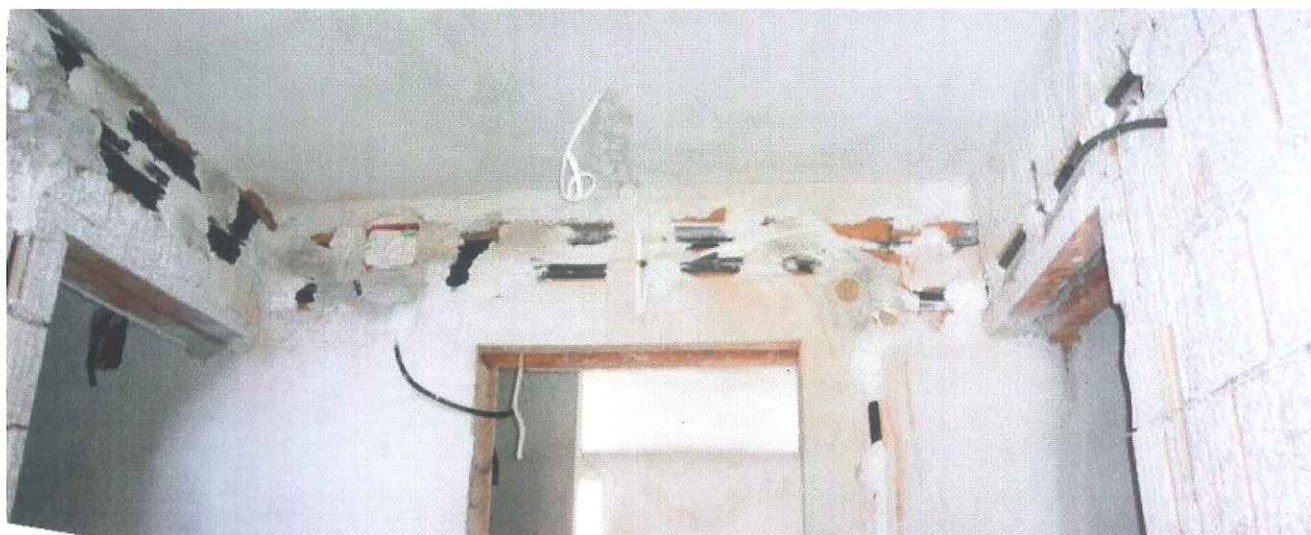
Lépcsőházban elektromos kábelezés
